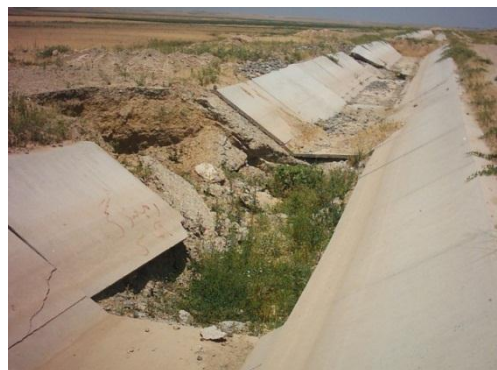
شکل ۱- زیر شویی خاک زیر پوشش بتنی و تخریب پوشش در قسمتی از کانال پمپاژ ۳ دشت مغان
